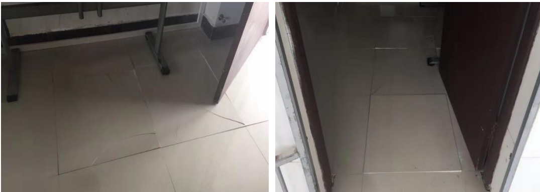
周二，2-523 教室，地板砖坏了 16 块，安全隐患。
