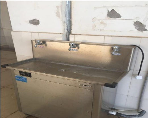
周五，2-612 旁热水器需维修。
